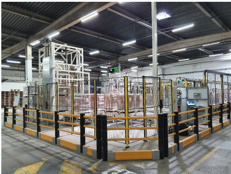
11944 164 Vue globale de l'installation
