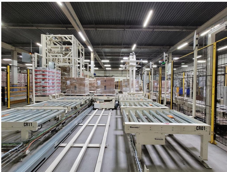
11944 207 Vue d'ensemble navette, gares de stockage et gerbeur
