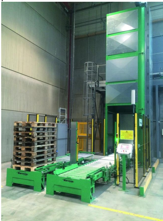
Poste de dépose/reprise dans Vémars 3 avec Montepal® pour liaison vers passerelle
