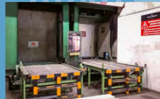
Mise en sécurité d'un élévateur
