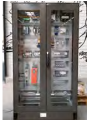
Armoire électrique Armoire de puissance et de commande.
