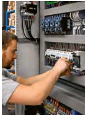
Armoire électrique Câblage.
